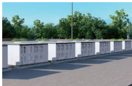
STAZIONE DI GENERAZIONE DI ENERGIA ELETTRICA
