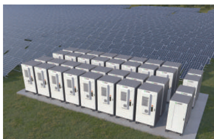
STAZIONE DI GENERAZIONE DI ENERGIA ELETTRICA
