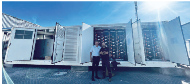
Renon Estation 744 kWh Capte Town, SA
